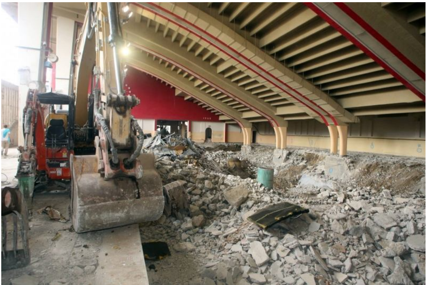
... et sa démolition en ce début de semaine.© Photo Vidal Thierry Daniel
